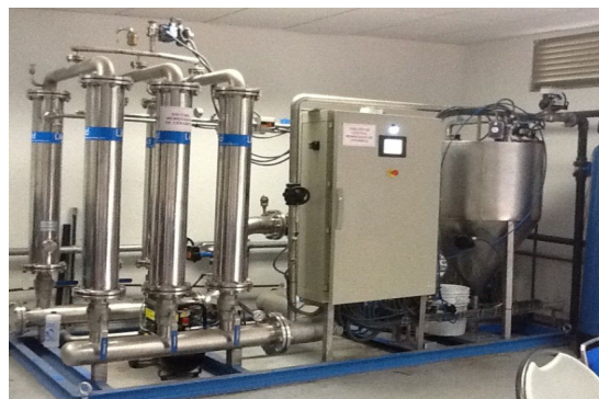
Ilustración 7. Equipos de la Planta de Tratamiento de Aguas Residuales.
