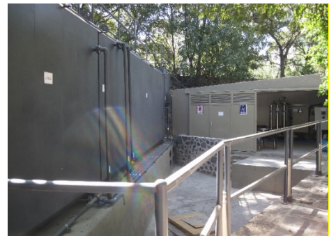
Ilustración 1. Planta de tratamiento
