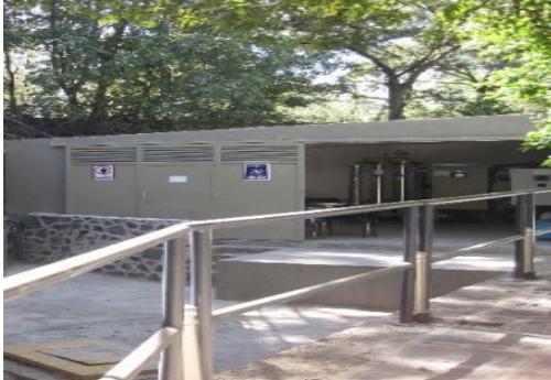
Foto no. 3 Planta de tratamiento
