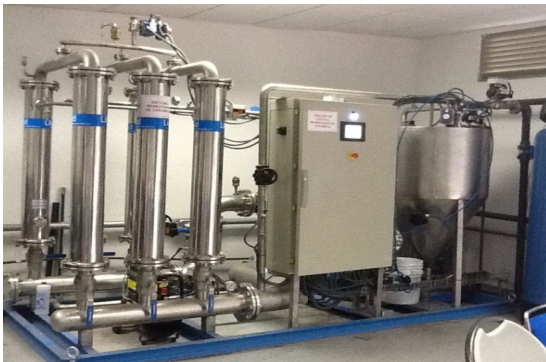
Equipos de la Planta de Tratamiento de Aguas Residuales
